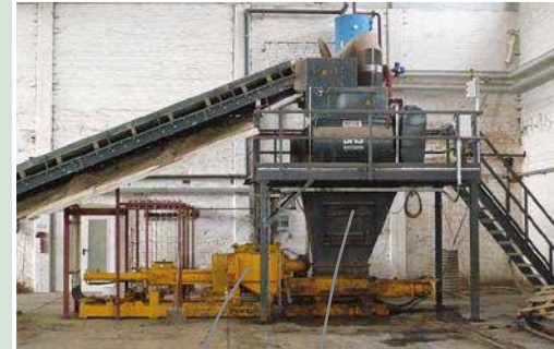
zentrale Putzmeister-Misch- und Dosierstation
